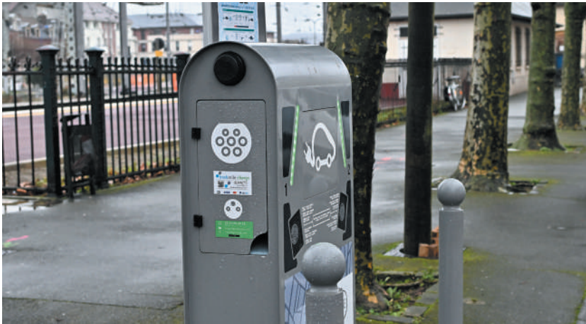
Les nouvelles stations de recharge pour les véhicules électriques
