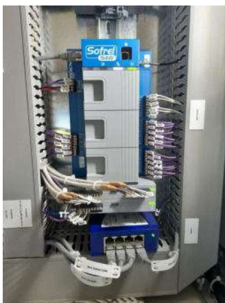
système de télécommunication au réservoir
