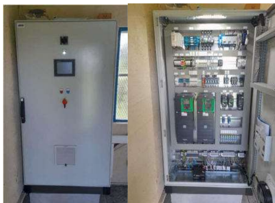
Armoire électrique et système de télécommunication renouvelés
