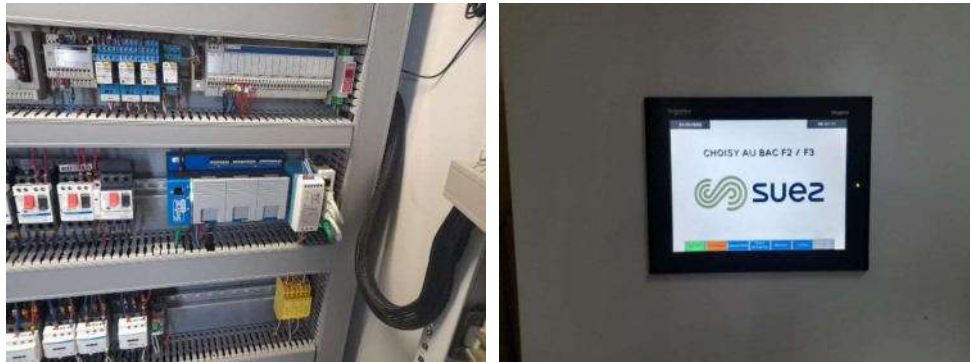
Nouvel automate mis en place sur la station de production de Choisy-au-Bac
